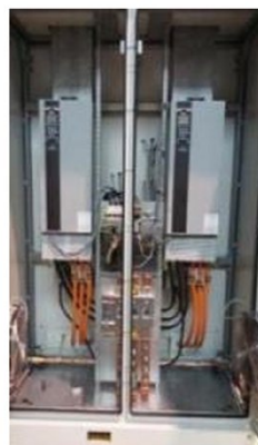
Variadores del compresor + conexión de alimentación principal
