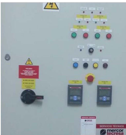
Cuadro de presurización
